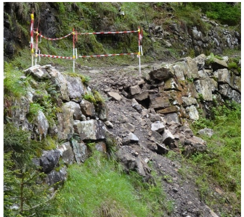
Objekt 21: Defekte Randhölzer
